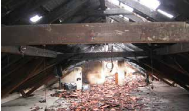
Bild: Kinder zündelten im nicht ausgebauten Dachraum.
