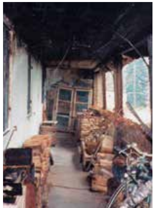
Lagerung auf der Veranda ist gefährlich. Fahrlässige oder mutwillige Brandstiftung vom o. g. Personenkreis ist möglich.
