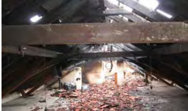
Bild: Kinder zündelten im nicht ausgebauten Dachraum.
