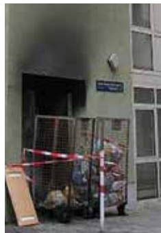
Bilder: Laderampe und Anlieferungsbereich: Rauchzeugreste führten zum Brand.
