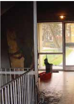
Ein Kinderwagen wurde angezündet. Der Brandrauch zog ins Treppenhaus (Fluchtweg).
