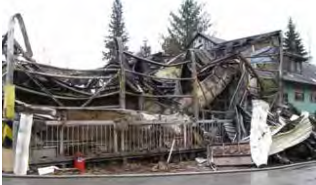
Fahrlassige Brandstiftung in einer Abfallbox. Die Trennwand begrenzt den Brandübergreif auf das Wohnhaus.
